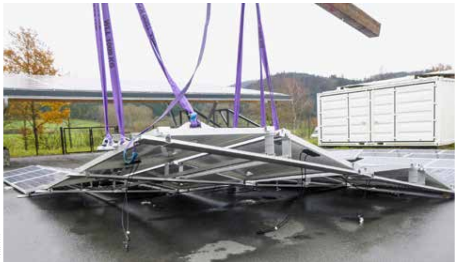
Der Albtraum jedes Installateurs: Ein Windstoß hebt die Solaranlage aus und fegt sie vom Dach.
